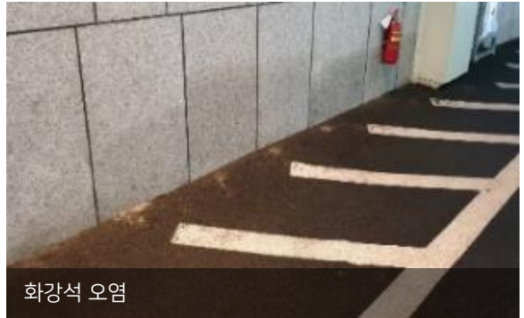
사진6-2. 방풍실 외부 주차장 인접 화강석 판재 오염 사진
