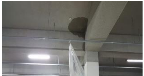
사진3. 지하 1층 주차장 천정 누수
