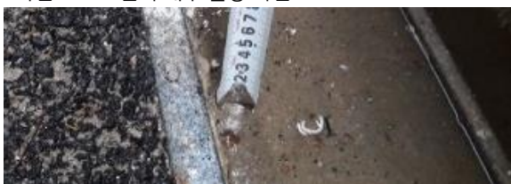
사진5-1. 트랜치 배수 불량 사진
