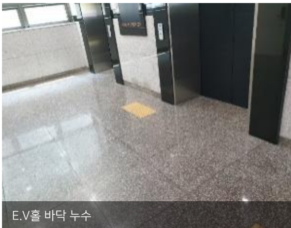
사진6-1. 코어 부분 누수 사진
