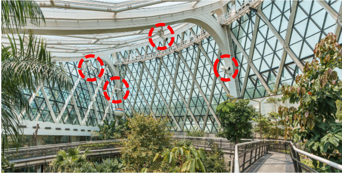
<사진5> 마곡 서울식물원에 설치된 전기 온풍기
