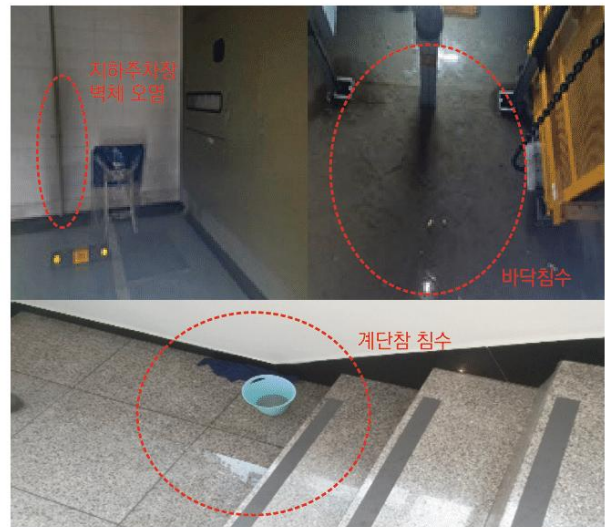
〈사진2〉 누수로 인한 피해
