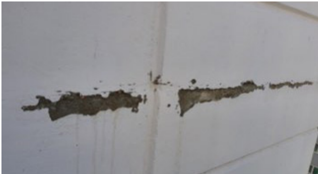
〈사진4〉 어젤리아 신천아파트 외벽 균열보수(전)
