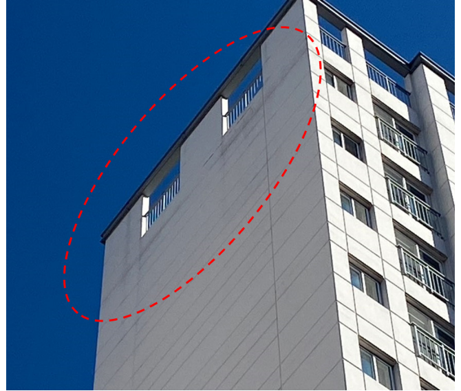
〈사진1〉 어젤리아 신천아파트 102동 15~14층 콜드조인트 발생
